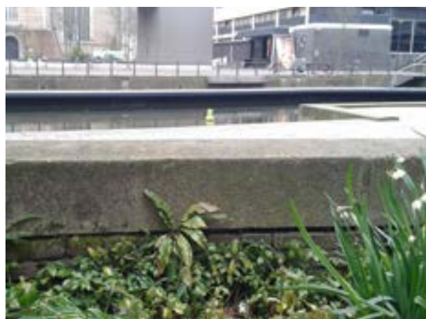
Rotterdam: in een plantenbak verwerkt stuk kademuur met op de achtergrond het Grote Kerkplein.
