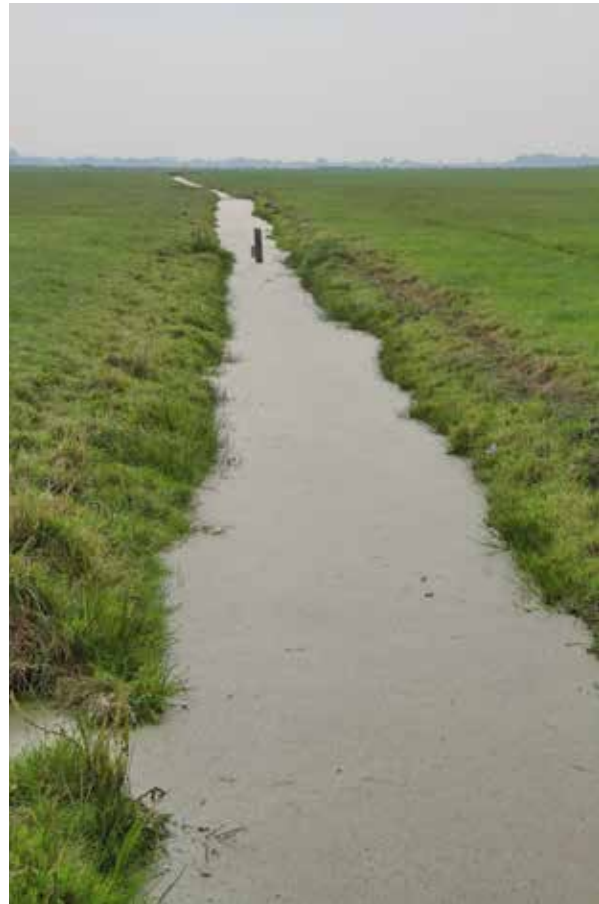
Figuur 2 Perceelsloot toe aan onderhoud.
